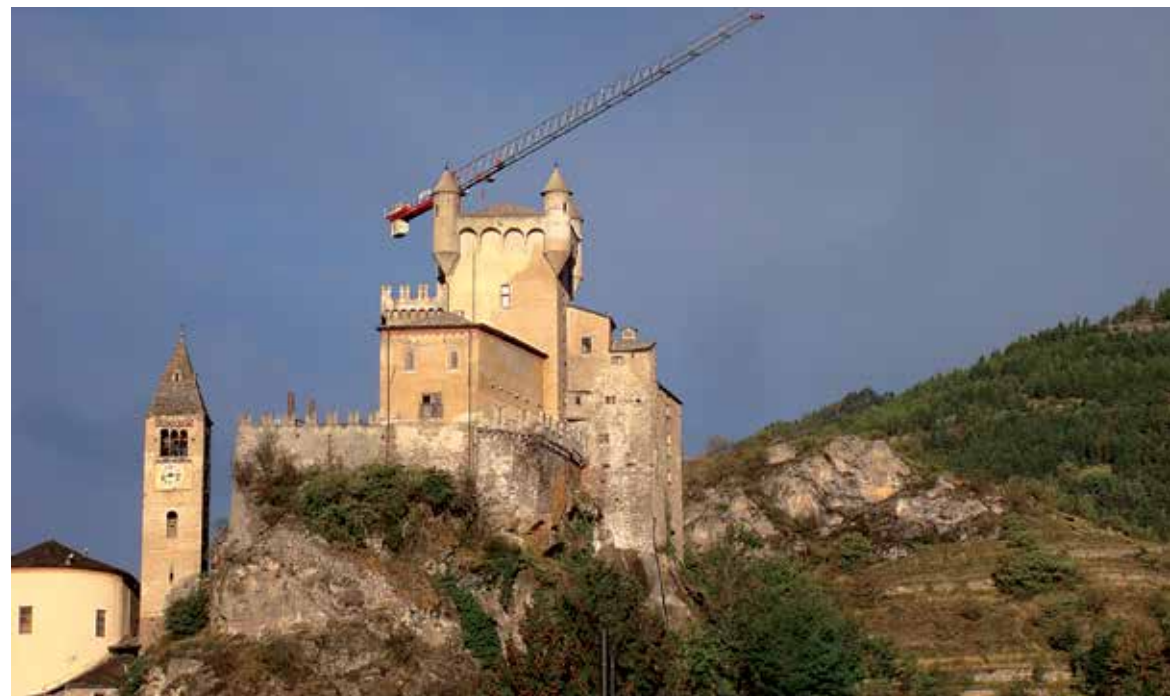
Si installa il cantiere al Castello di Saint-Pierre (Foto I. Vanacore Falco)
